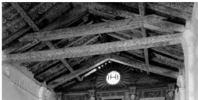
Fig. 10 Techo del presbiterio de la iglesia de Concepción de Chiquitos , con restos de una pintura de romboides, desfigurada por repintes posteriores. Foto: Felix Plattner y Albert Lunte, 1957.
